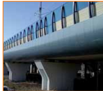
Linea ad Alta Velocità nei pressi di Roma: pannelli antirumore
