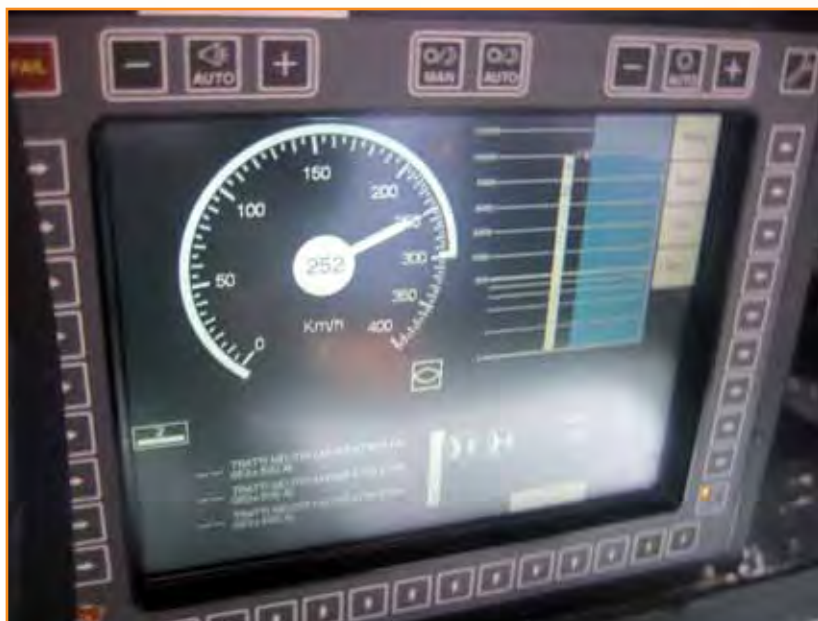
Sistema ERTMS: pannello di controllo del macchinista
